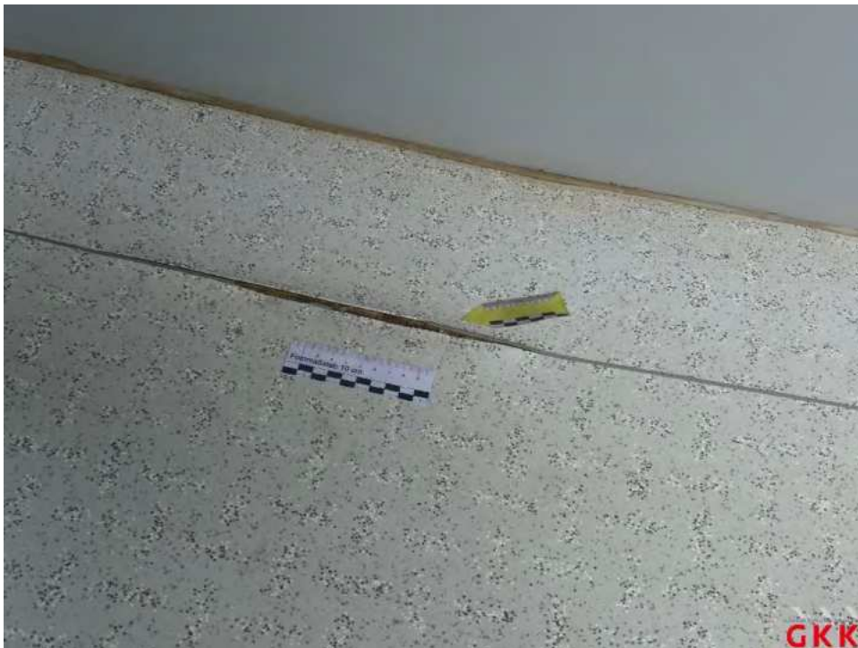
Bild 48 Laderaum, Bodenbelag, beschädigt, instand setzen
