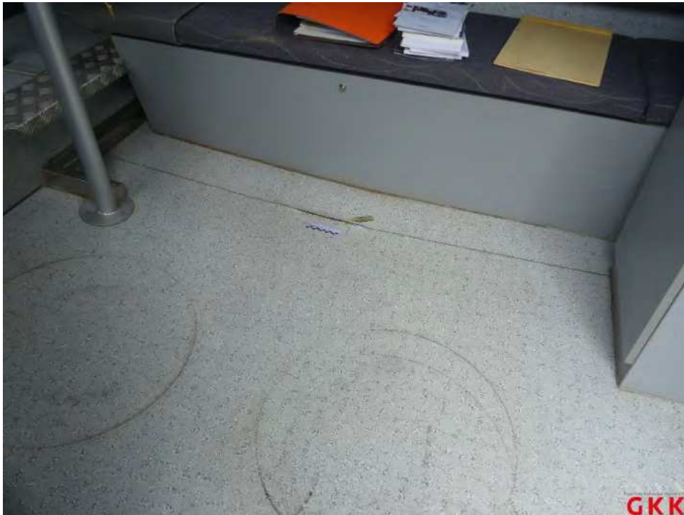
Bild 47 Laderaum, Bodenbelag, beschädigt, instand setzen
