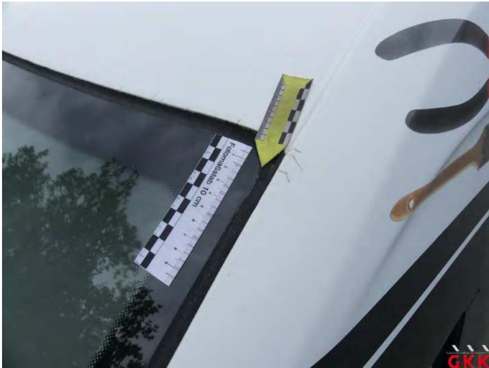
Bild 59 Frontscheibe, gerissen, ersetzen
