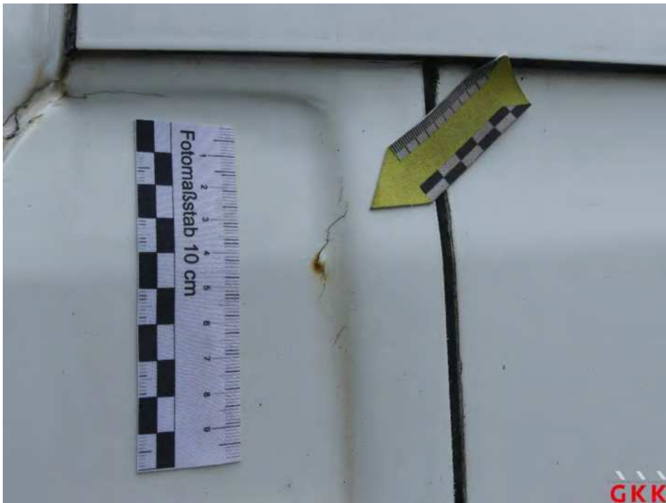
Bild 42 B- Säule links, beschädigt, instand setzen - lackieren
