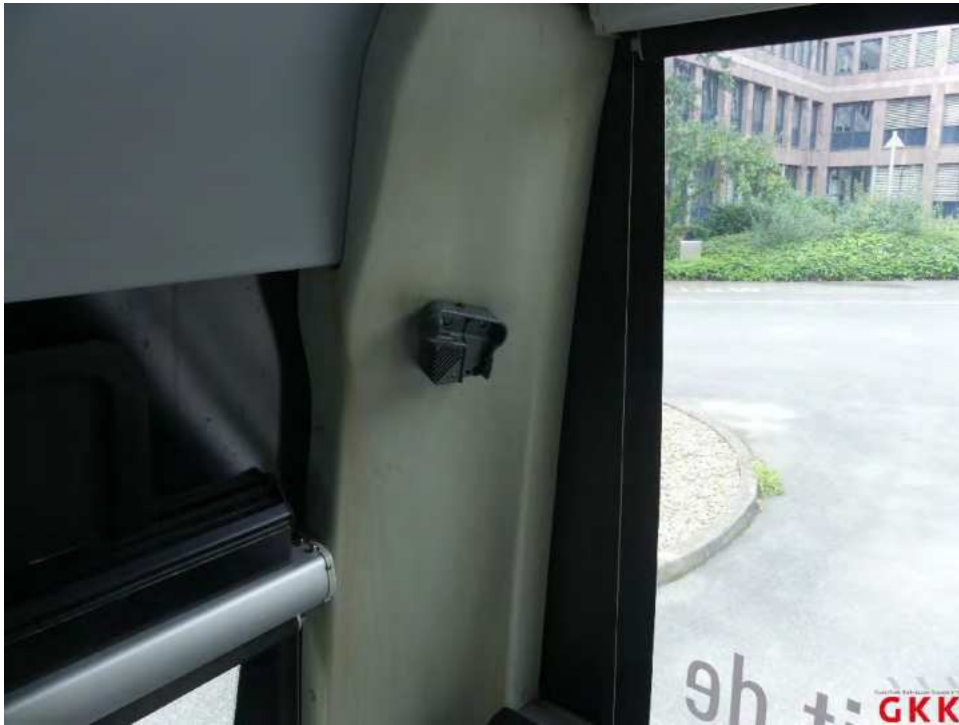
Bild 51 1x Nothammer, fehlt, ersetzen
