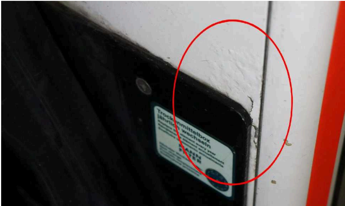
Bild 13: Rostansatz Aufbau-Vorderwand links
