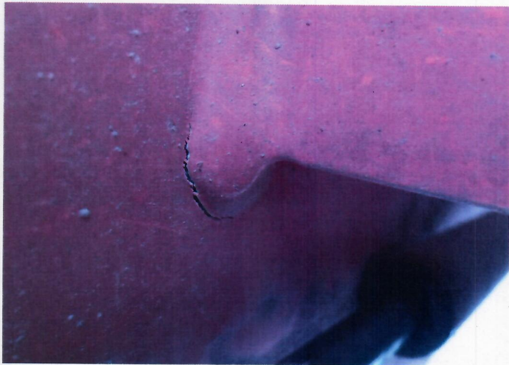
Bild 11 : Bühnenkonsole verformt und gerissen
