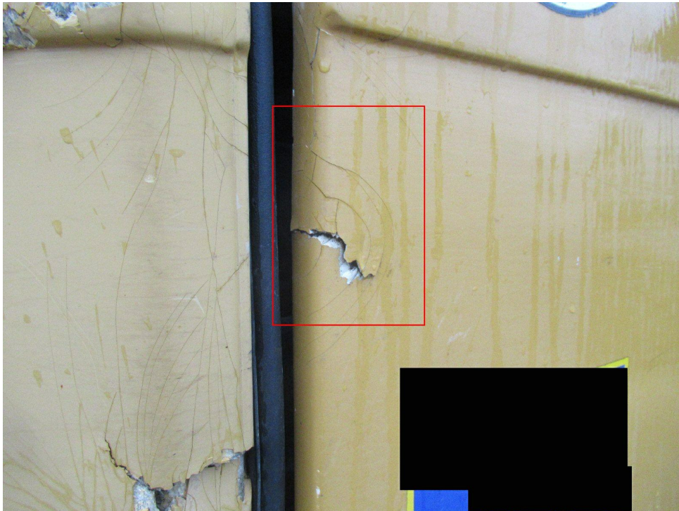
Bild 9 : Diverse Abdeckungen sind gerissen
