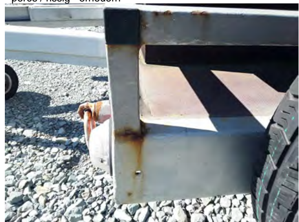
Beschädigung 8: Sonstiges: Fahrzeug (Rahmen) - Korrosio... instandsetzen
