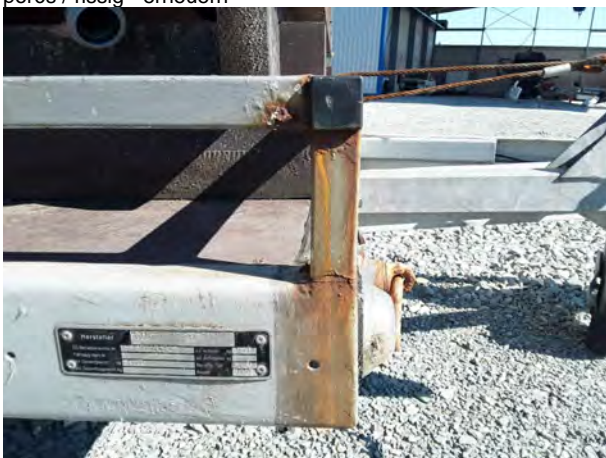
Beschädigung 8: Sonstiges: Fahrzeug (Rahmen) - Korrosion - instandsetzen
