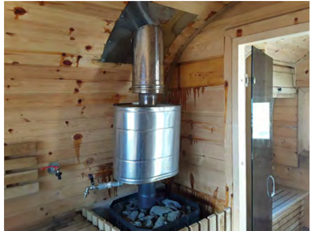
Beschädigung 1: Sonstiges: Sonstiges (Fass-Sauna aufgebaut, Zustand bitte den Bildern entnehmen) - kein Abzug
