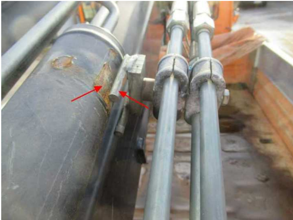
Bild 27 : diverse Hydraulikleitungen deformiert und teilweise lose, prüfen und erneuern
