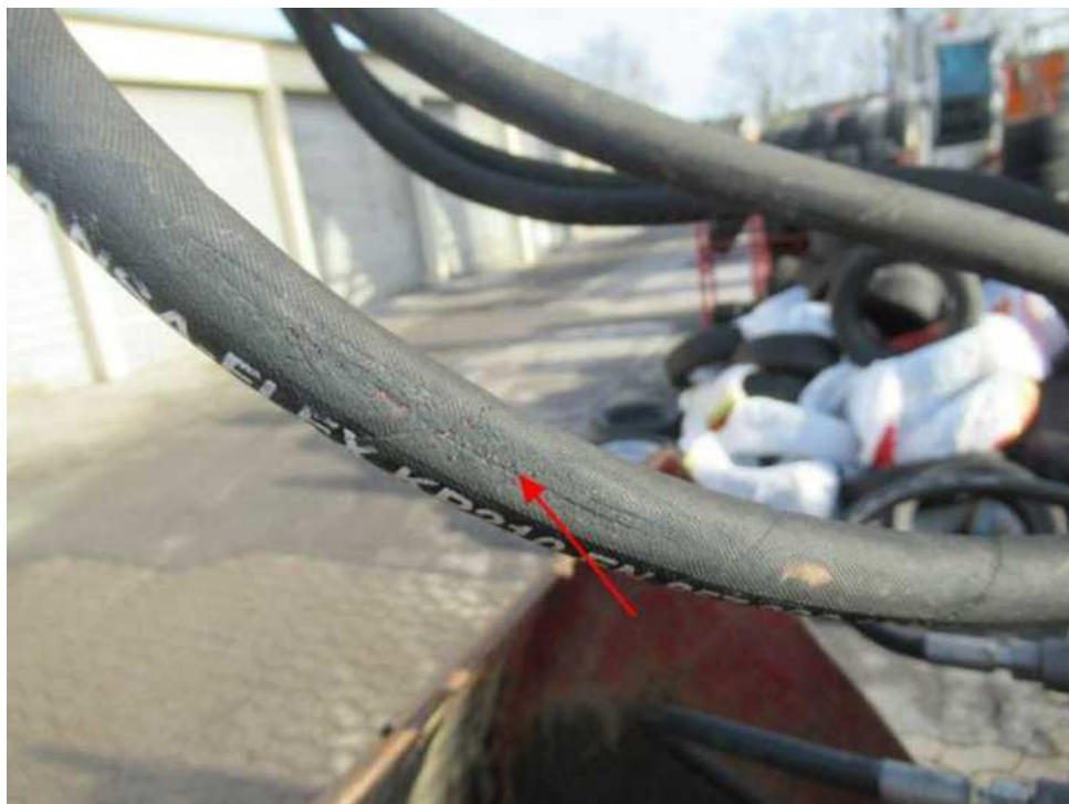
Bild 24 : diverse Hydraulikschläuche aufgerieben, prüfen und erneuern
