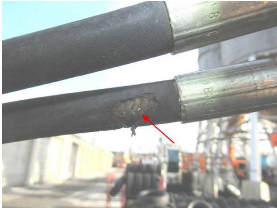
Bild 23 : diverse Hydraulikschläuche aufgerieben, prüfen und erneuern
