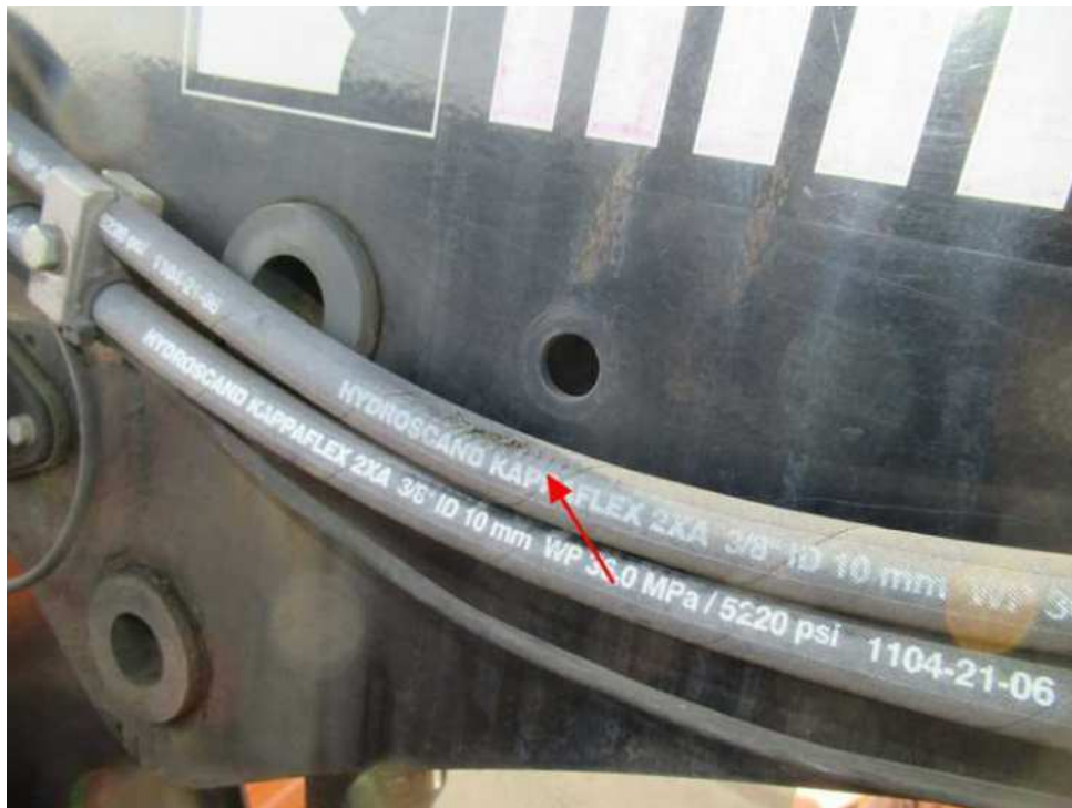
Bild 25 : diverse Hydraulikschläuche aufgerieben, prüfen und erneuern
