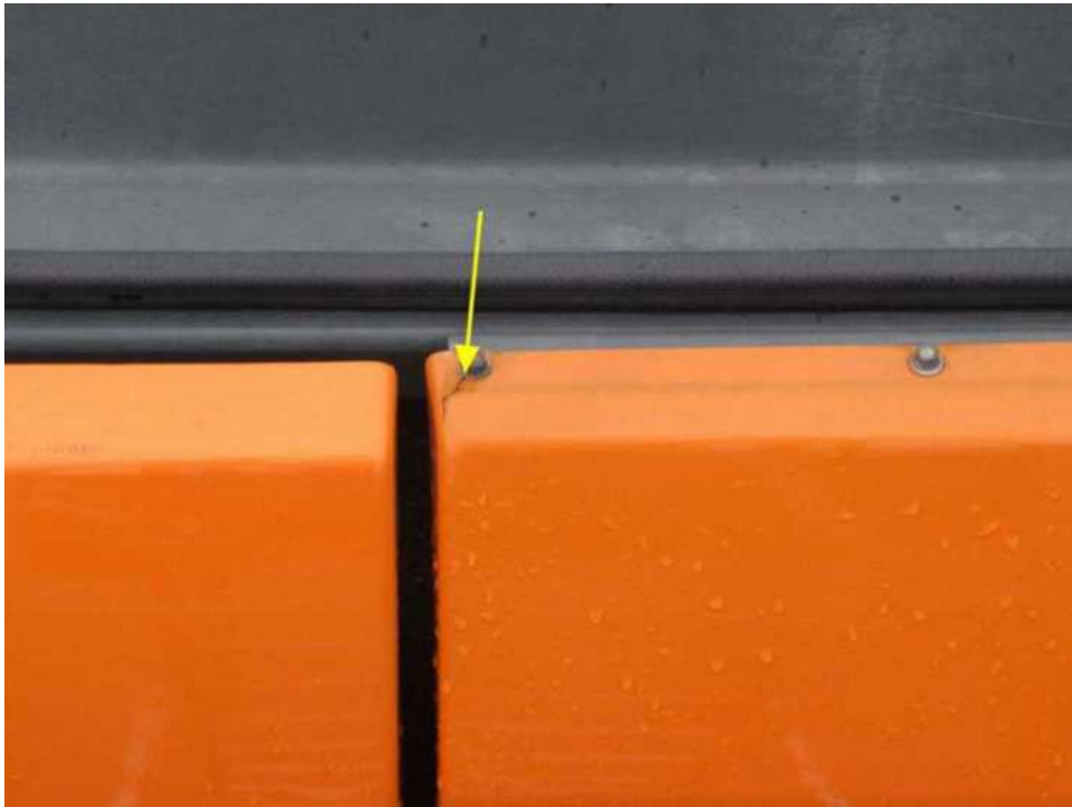
Bild 23 : Behälterverkleidung links gerissen
