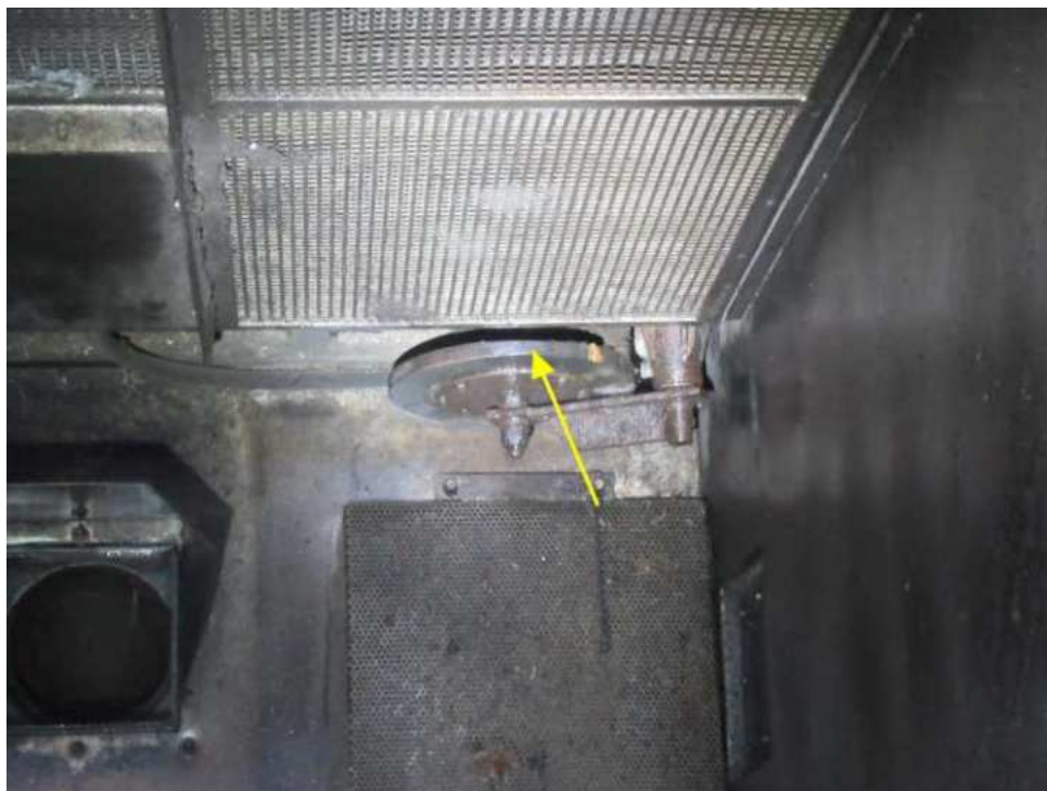
Bild 21 : Schiebevorrichtung für den (Laub)Saugschlauch defekt
