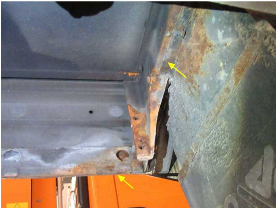
Bild 32 : Radläufe der hinteren Seitenwände starker Rostbefall
