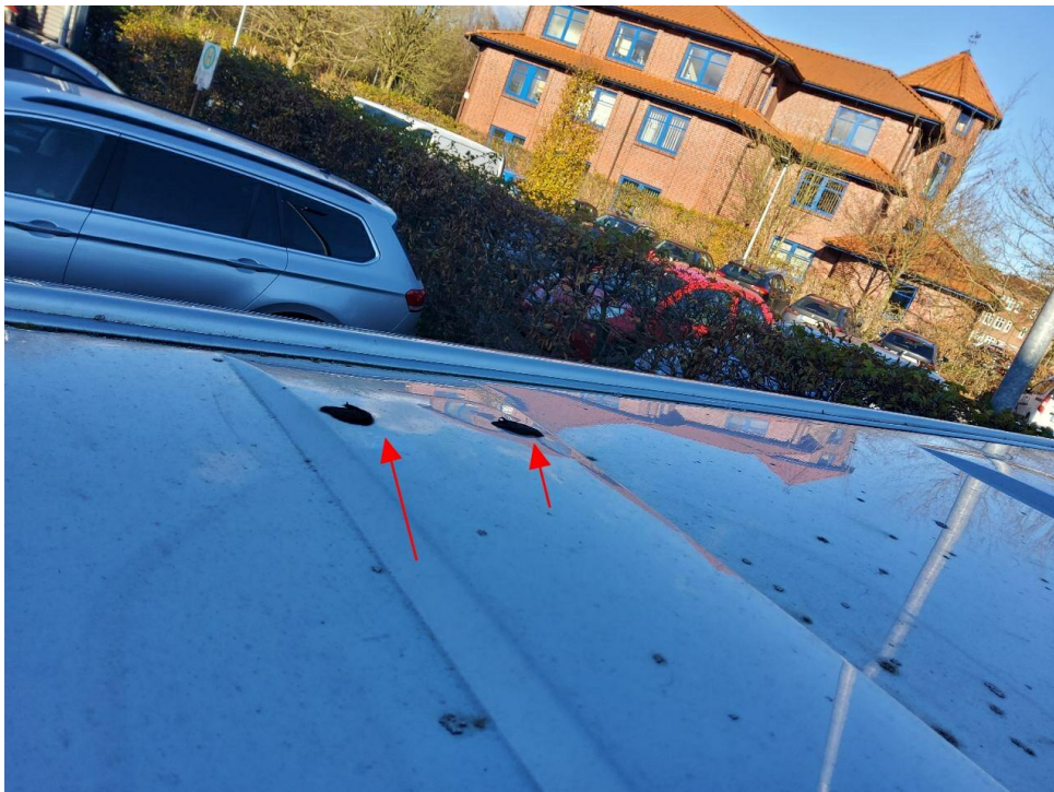
Bild 10 : Dachhaut Löcher von der Signalanlage
