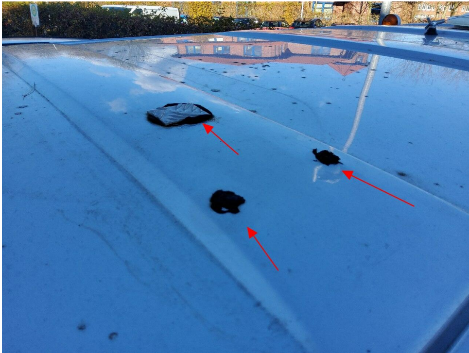
Bild 9 : Dachhaut Löcher von der Signalanlage
