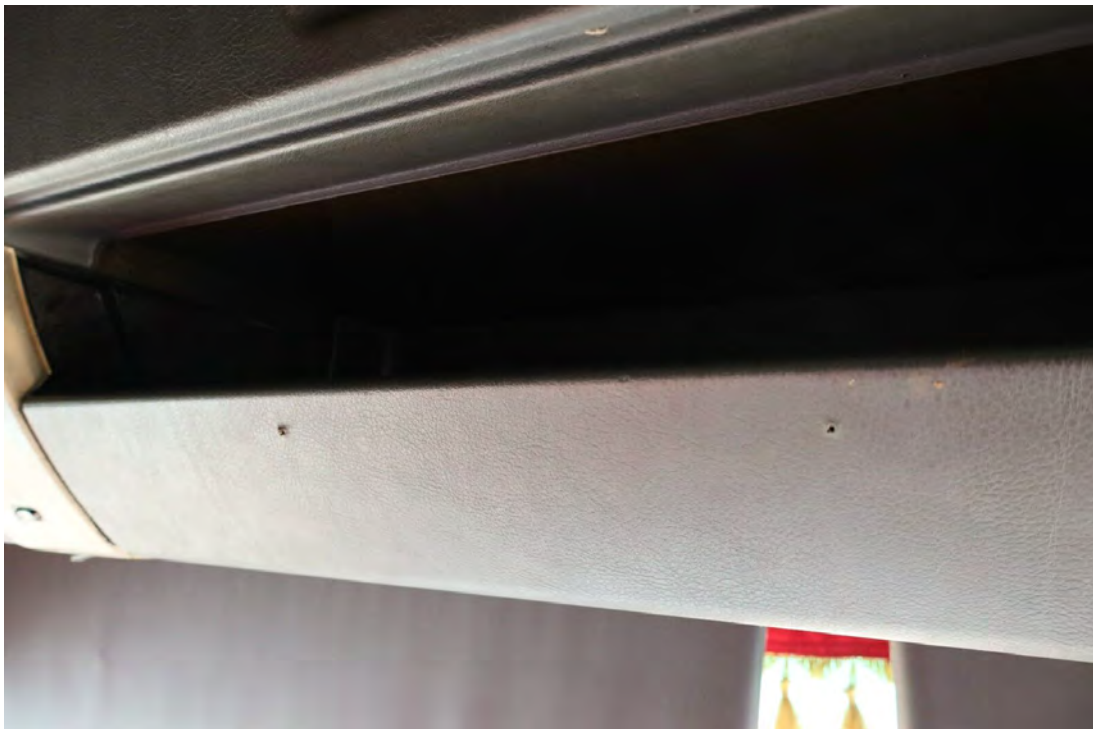
Bild 10 : div.Verkleidungen A-Tafel gebrochen/angebohrt
