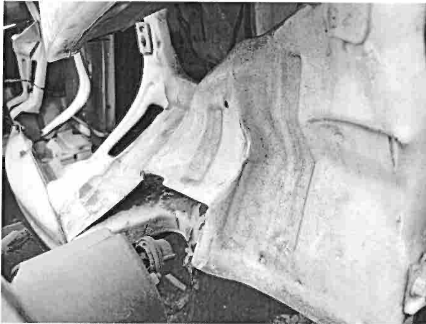
Bild 15: Schlosssträger vorne stark deformiert
