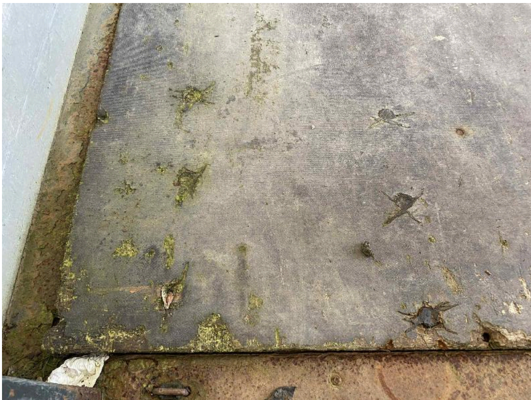
Bild: 10 Ladeboden beschädigt
